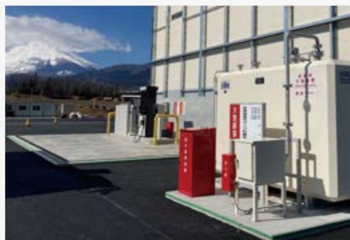
静岡県 自家用給油所
