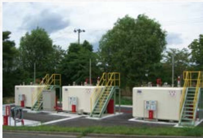
宮城県 緊急発電用
