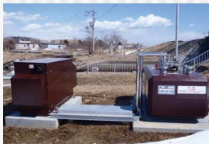
北海道 水門開閉装置
